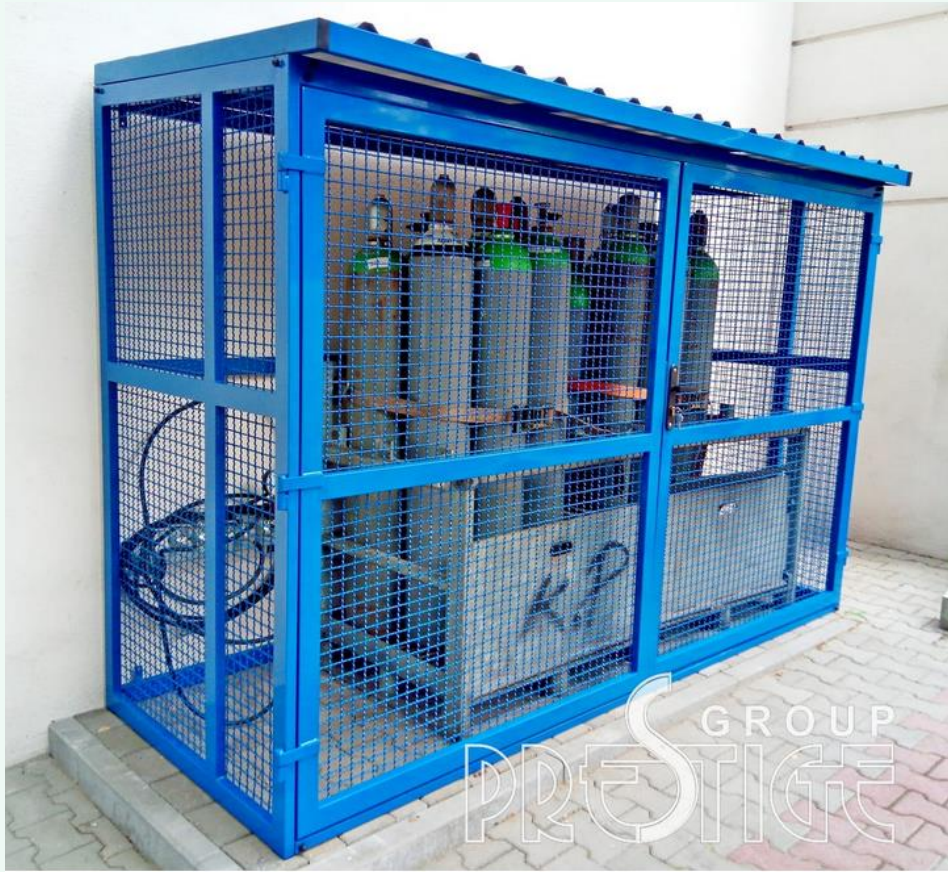
klatka (szafa) na stojaki z butlami gazowymi
